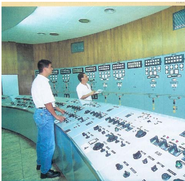
Sala de controle da Usina de Furnas
