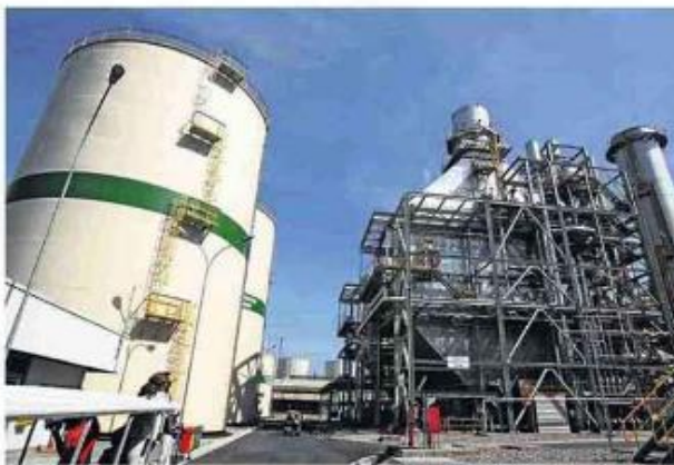
Usina termelétrica a gás natural, TermoRio, em Duque de Caxias (RJ)
