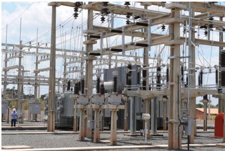
Subestação da Eletrobras Piauí Divulgação/Divulgação
