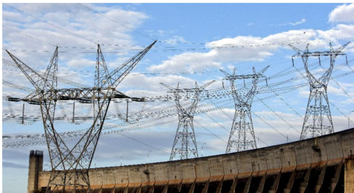
Linhas de transmissão de energia da usina hidrelétrica de Itaipu Imagem: Adriano Machado/Bloomberg
