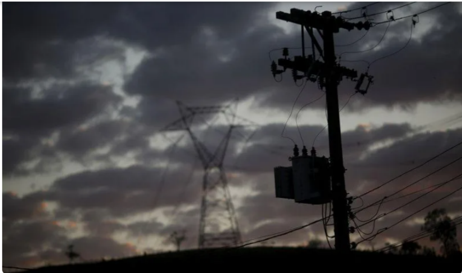
Linhas de transmissão e distribuição de energia em Monteiro Lobato (SP)
