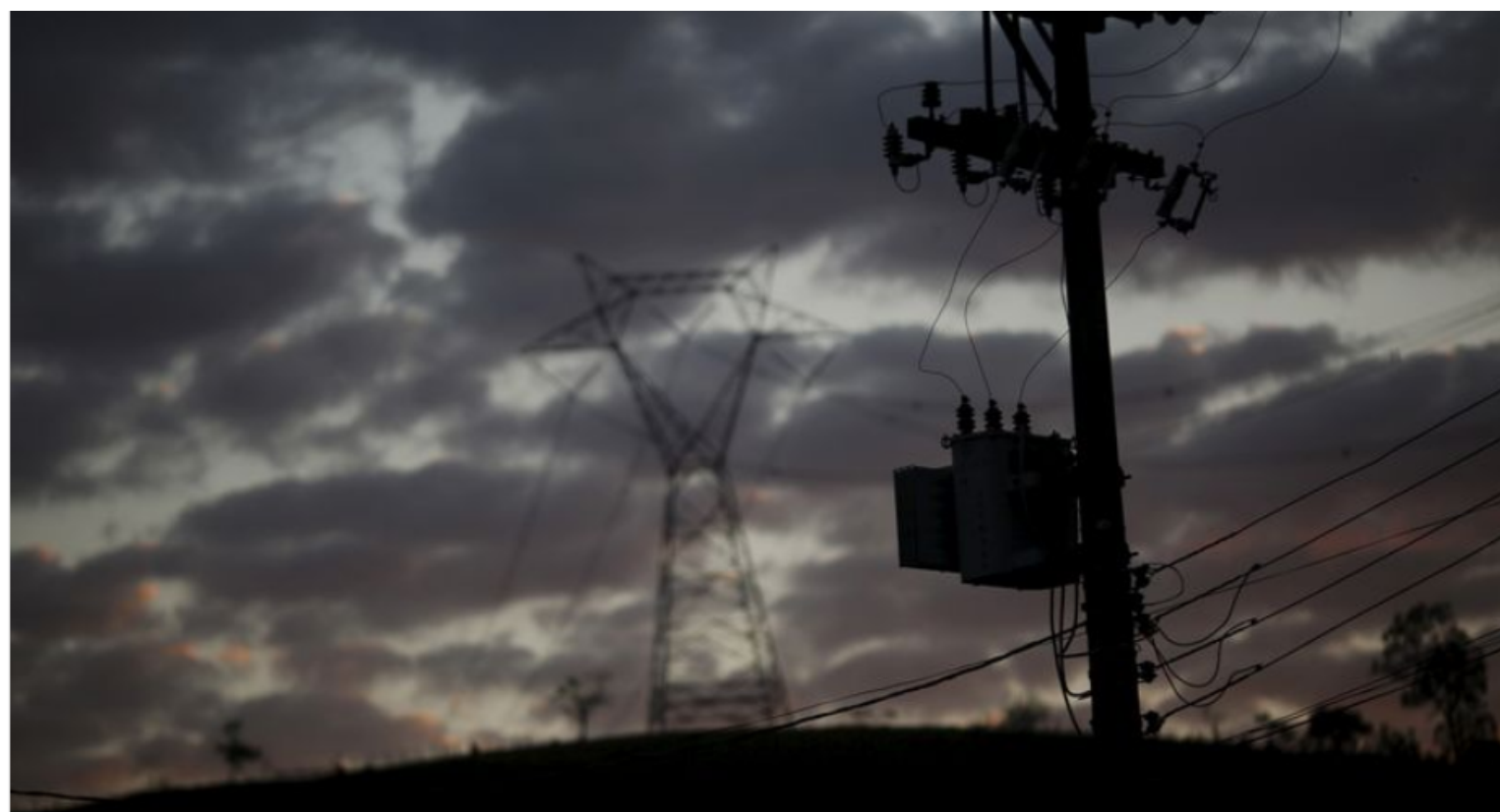
Linhas de transmissão e distribuição de energia em Monteiro Lobato (SP)
