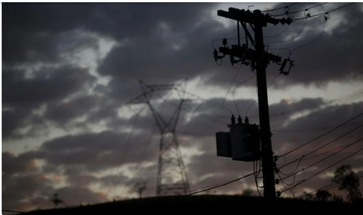
Linhas de transmissão e distribuição de energia em Monteiro Lobato (SP)
