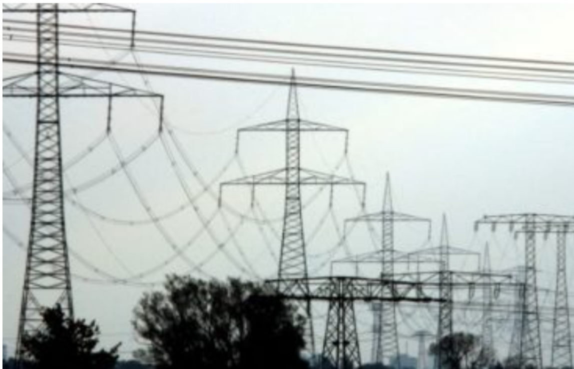
Linhas de transmissão de energia
