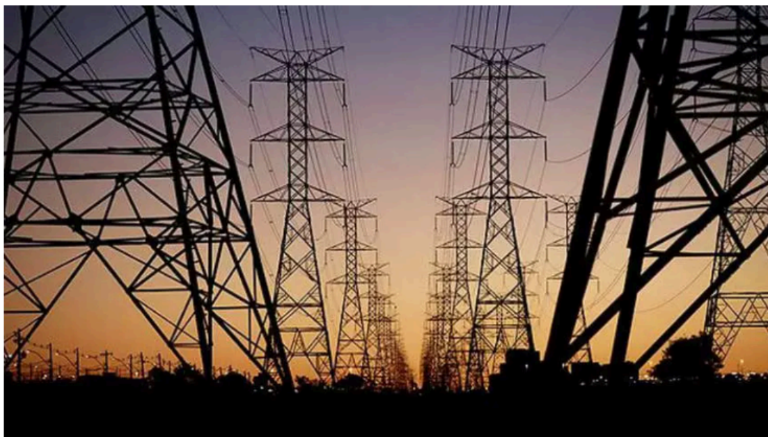
Linhas de transmissão, um dos ativos de Furnas
