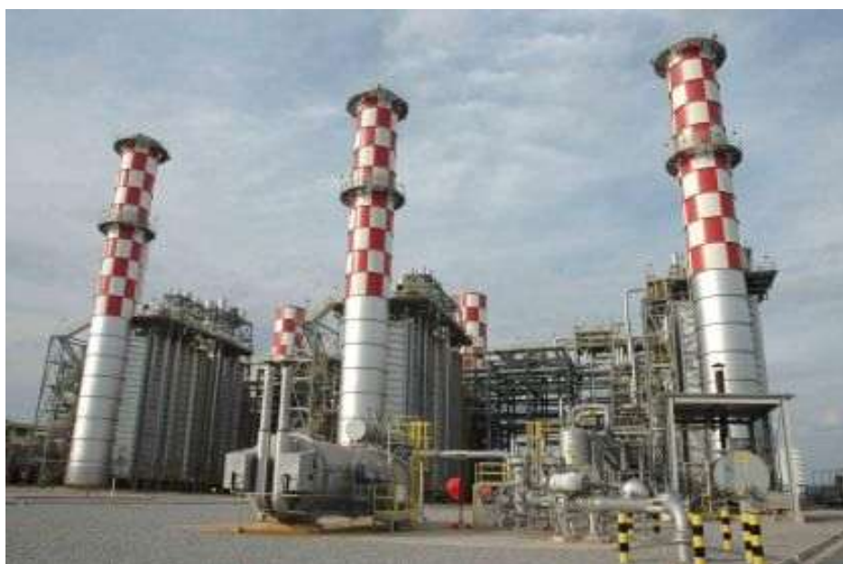
Usina térmica da Petrobras • Divulgação
